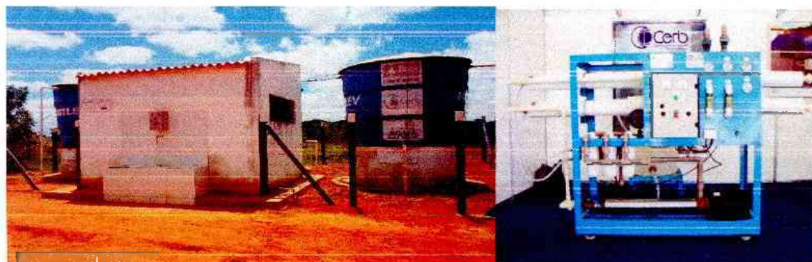
Figura 95 – Dessalinizador de água por osmose reversa
