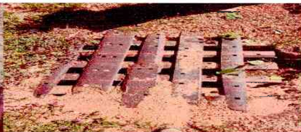
Canal obstruído na Avenida Ayrton Senna
