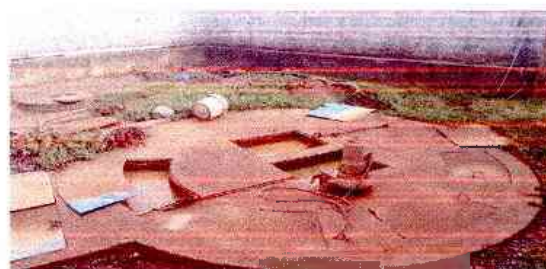
Poço da EEE01 em março de 2019, após enchente que inundou a estação
