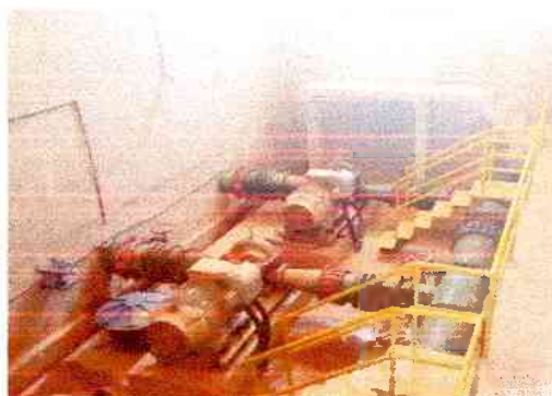
Estação Elevatória de Água Bruta
