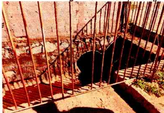
Esgotos na micro drenagem da Av. LEM
