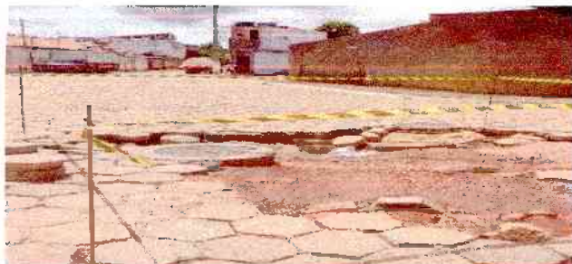
Processos erosivos no calçamento, expõem a rede coletora de esgotos
