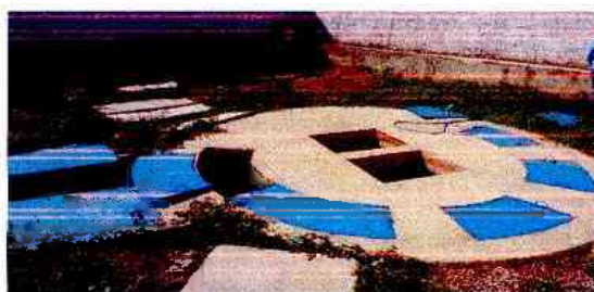
Poço da EEE01 em janeiro de 2019
