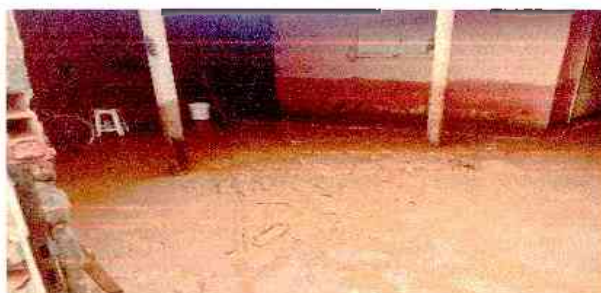
Moradia após alagamento com detalhe da marca na parede do nível alcançado pela enchente
