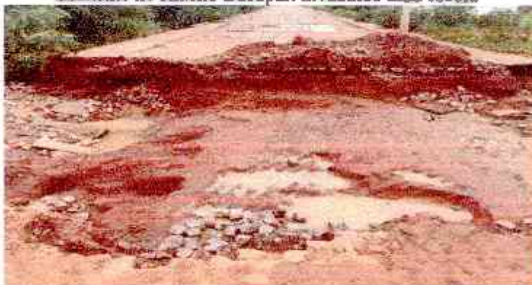
Aterro da rua que liga o Alto da Varginha ao Alto da Usina, que precisou ser removido para auxiliar o escoamento
