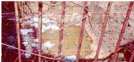
Acúmulo de lixo no canal de drenagem da rua LEM
